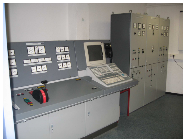
Salle de contrôle des moteurs
